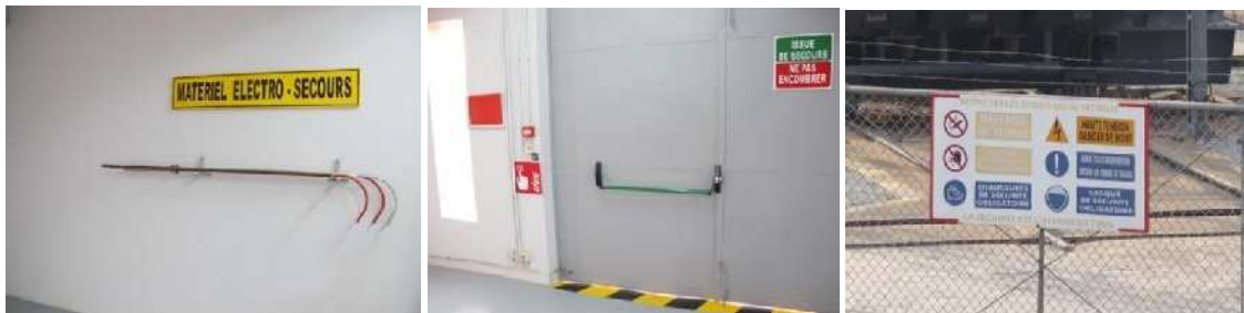
Photo 3: Signalétique de sécurité au poste source GBEGBO Fulgence, 2017
