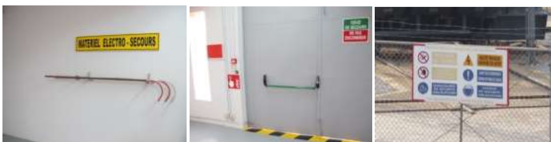
Photo 15: Signalétique de sécurité au poste source GBEGBO Fulgence, 2017
