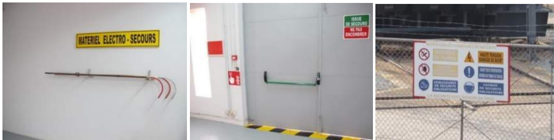
Photo 31: Signalétique de sécurité au poste source GBEGBO Fulgence, 2017
