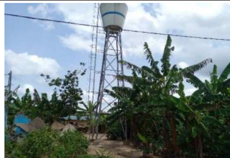
Vue du château d'eau de N'GOKRO
