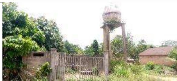
Aperçu d'un forage non fonctionnel à Wogninkro
