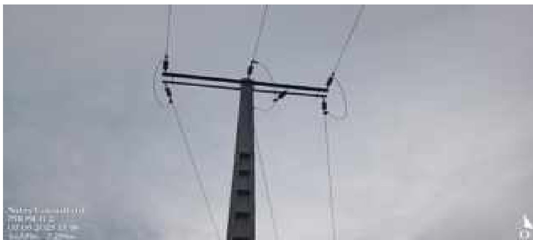
Vue de la ligne électrique de Koto 3 (ligne de moyenne tension, prise de vue 07 mai 2025)
