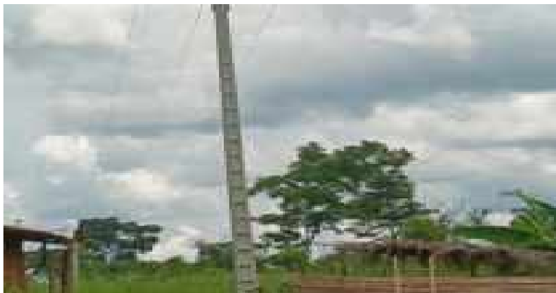
Ligne MT avec des support en béton, 28 avril 2025
