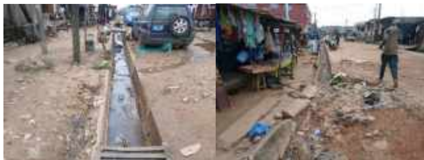
Planche 14: Vue des collecteurs obstrués dans la Commune de Yopougon
