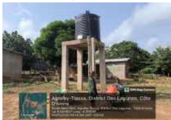
Château d'eau de forage à Tithio
