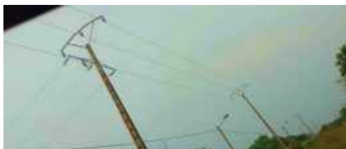
Photo 2 : Vue du réseau électrique de Kamelesso
