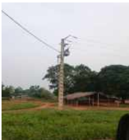
Vue de la ligne MT existant à Guiboua
