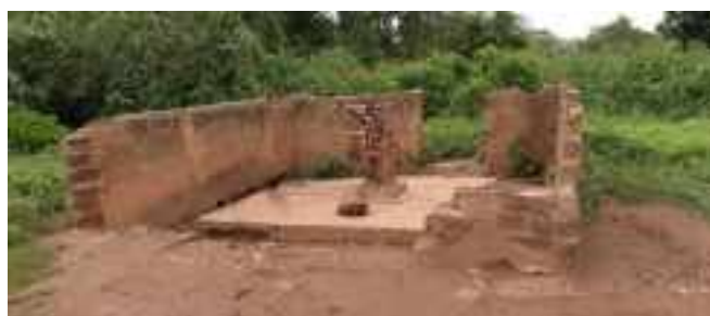
Photo 2 : Vue d'une pompe hydraulique villageoise à Kolokaha
